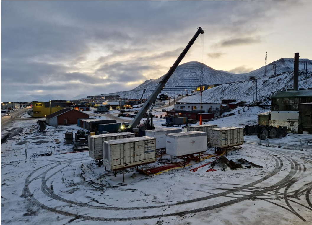
Figur 9: Batteripark under bygging høsten 2022. Foto Henriette Johansen
